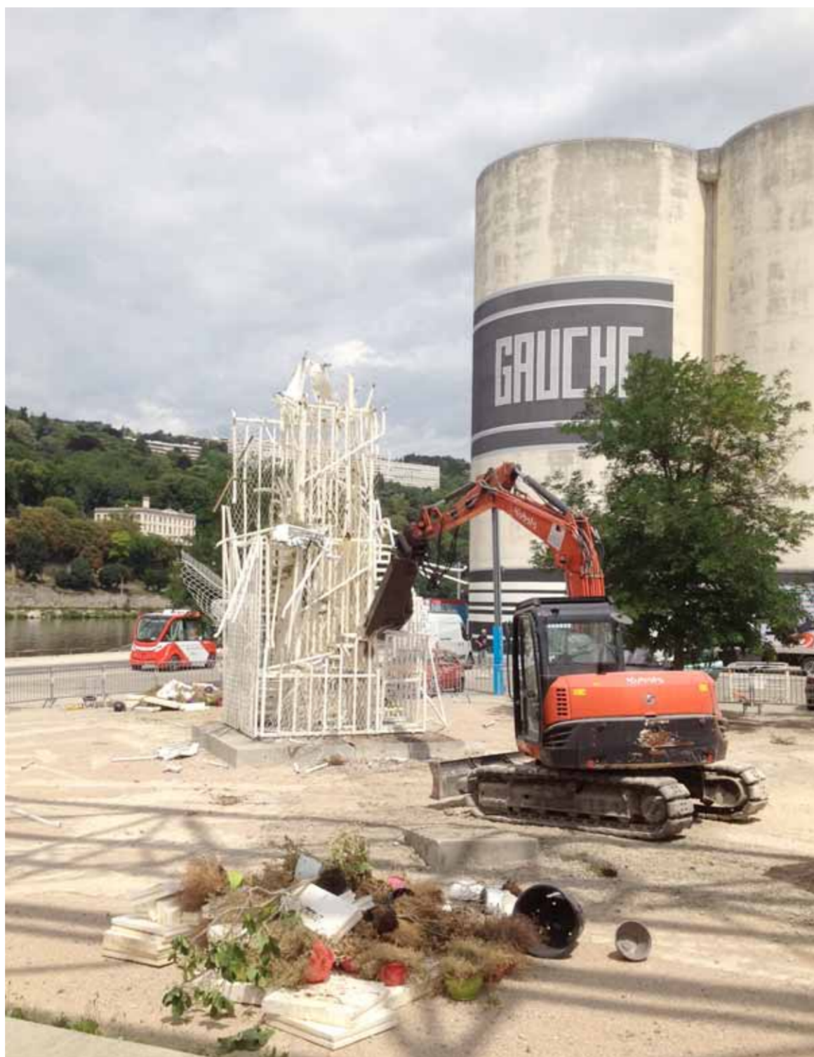
Démolition du Pavillon des fleurs, agence d'architecture Laisné-Rousselle, exposition Biennale d'Architecture de Lyon 2017, la Sucrière, stand «Habiter»
